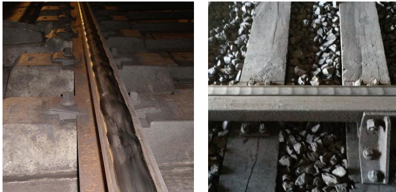
Abbildung 1: Gleisfehlstellen: Wellen (links), Riffel (rechts)
